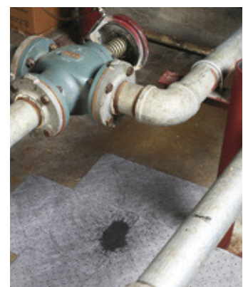
Gebruik pro-actief om onverwachte lekkages op te vangen.
